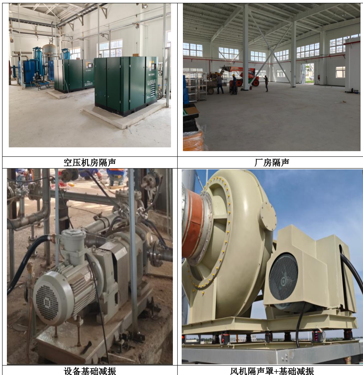
图 4.1-6 噪声污染防治设施建设情况
